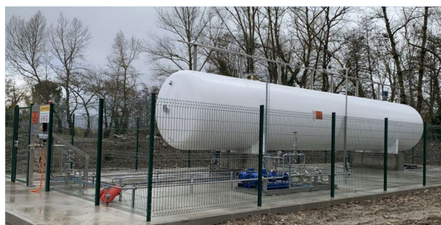
Illustration 4.2: Exemple comparable d'un réservoir (cuve) de gaz liquéfié
